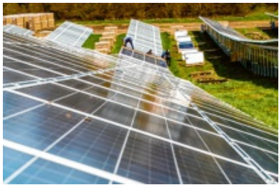
In Altstadt soll ein Solarpark gebaut werden. Foto: Ralf Lienert (Symbolbild)
