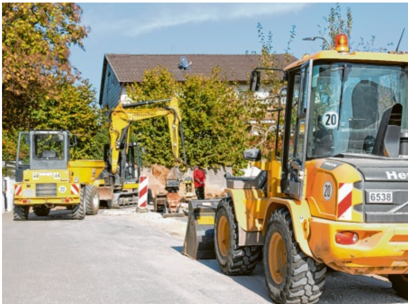
Wegen der Bauarbeiten am Wasserleitungsnetz in der Rosenstraße ist es zu Verunreinigungen des Trinkwassers gekommen. Foto: Michael Geyer
