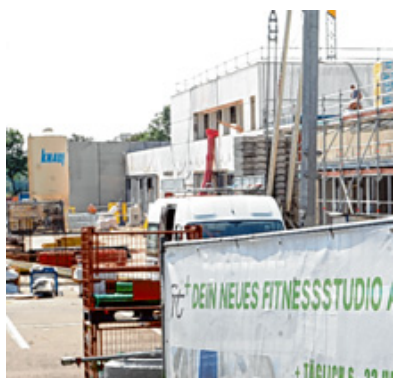
Die Baustelle für das Einkaufszentrum an der Nersinger Straße. Foto: A. Brücken
